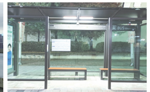
버스승강대 태양광조명 설치
