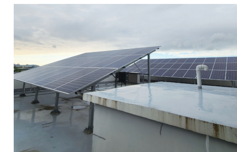
청라차고지 내 태양광 발전설비 운영
